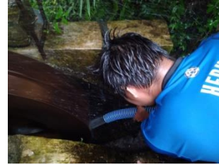
Gambar 16 Penyaluran Air ke Turbin Selang 2 inch
