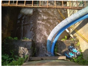
Gambar 13 Bak pada saat pipa pesat ditutup
