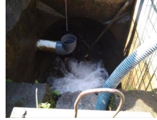
Gambar 14 Bak Penampung Saat Pipa Pesat Terbuka
