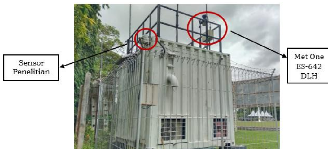
Gambar 2. Posisi pemasangan sensor terhadap instrumen referensi
